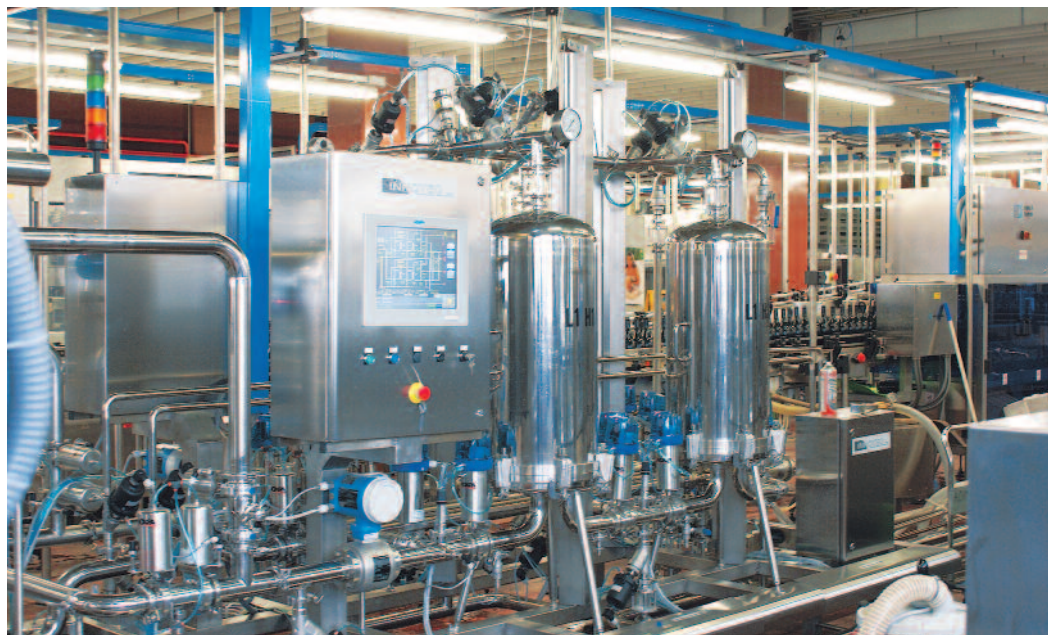
Installation de filtration entièrement automatique d'Innotec avec 2 lignes de filtration parallèles.
