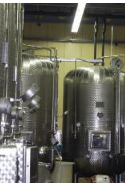
Mousseux-Tanklager, bestehend aus insgesamt 10 neuen Autoklaven von Della Toffola-Sirio Aliberti (ganz in Inox inkl. Isolation). Jeder Tank kann geheizt oder über die neue Kühlanlage auch gekühlt werden.
